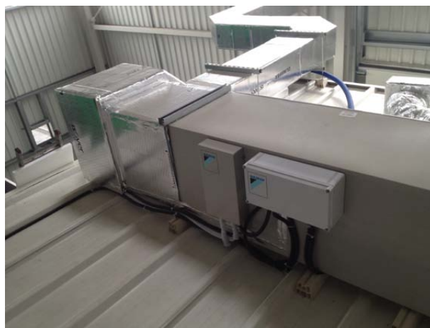
Rys. 2, 3. Przykład agregatu skraplającego pracującego w układzie z centralą nawiewną w trybie ogrzewania i chłodzenia kabiny technologicznej
